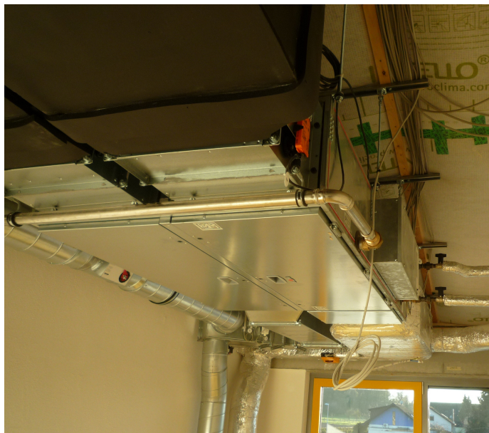
Abbildung 4 RLT- Anlage Kleinkinder
