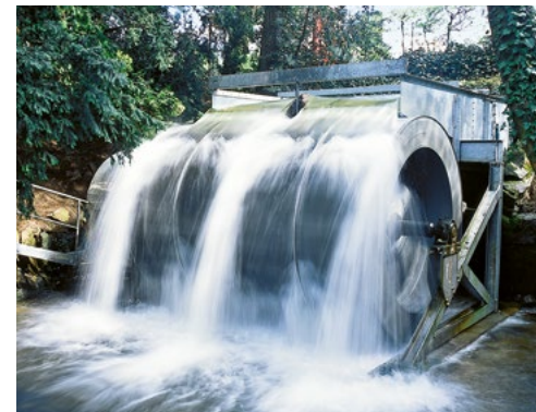
Wasserkraft-Anlage in Freiburg
