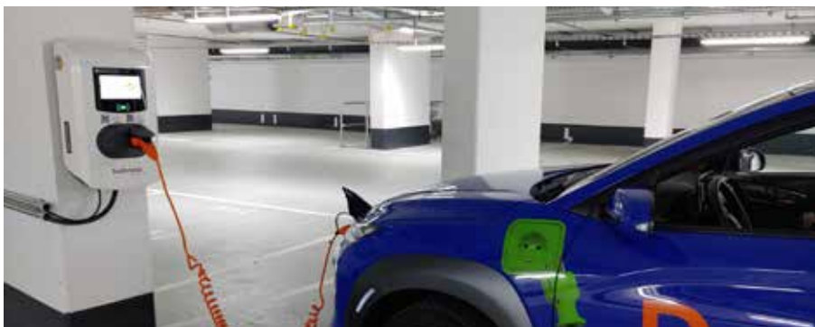
Ladelösung in der Tiefgarage der Volksbank Freiburg
