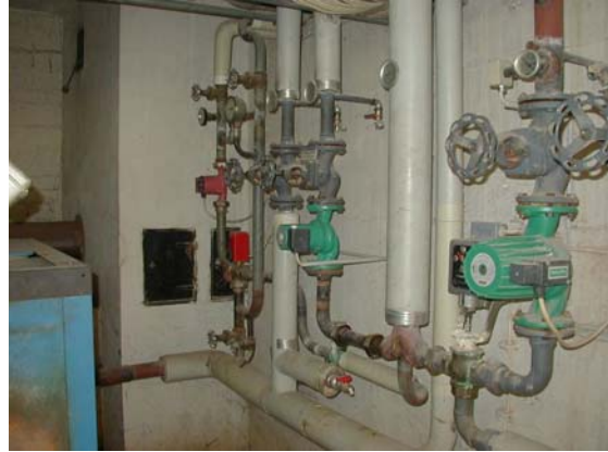
Kaum regelbare und schlecht gedämmte Heizungsverteilung
