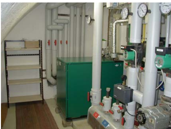
Neues Blockheizkraftwerk und neue Verteilung
