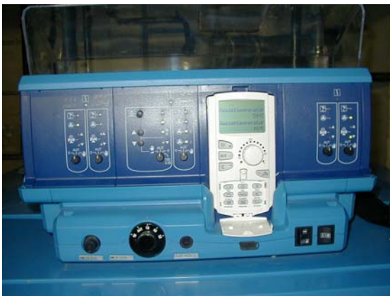
Moderne Regelung für den neuen Gas-Brennwertkessel und die Heizungsverteilung
