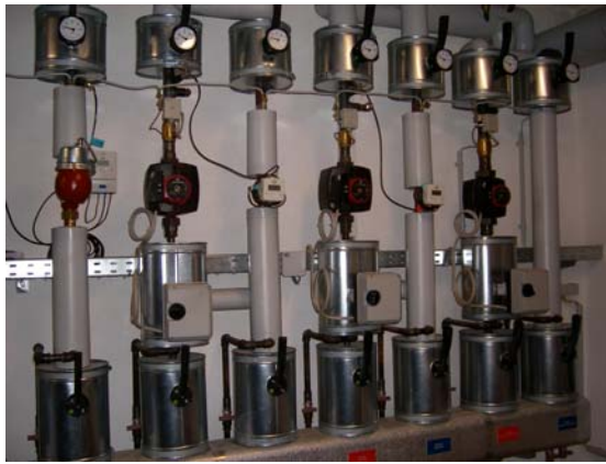
Neuer Heizungsverteiler mit modernsten Pumpen
