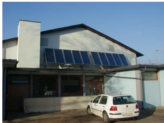
Sonnenkollektoren für die Warmwasserbereitung
