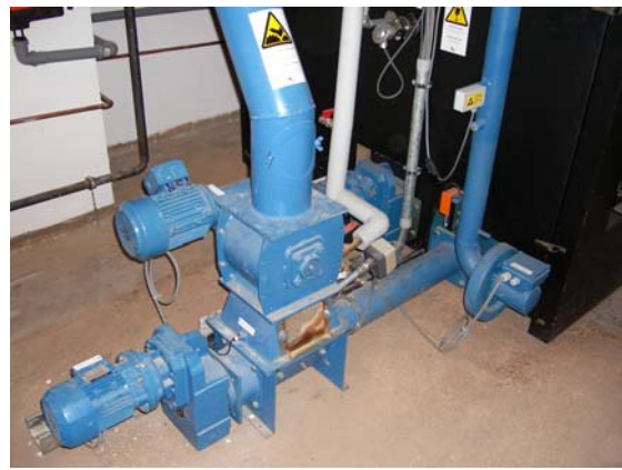
Fördereinrichtung des neuen Holzpellet-Heizkessels
