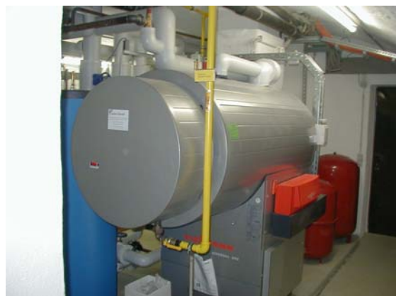
Neuer Gas-Brennwertkessel als Spitzenlastkessel
