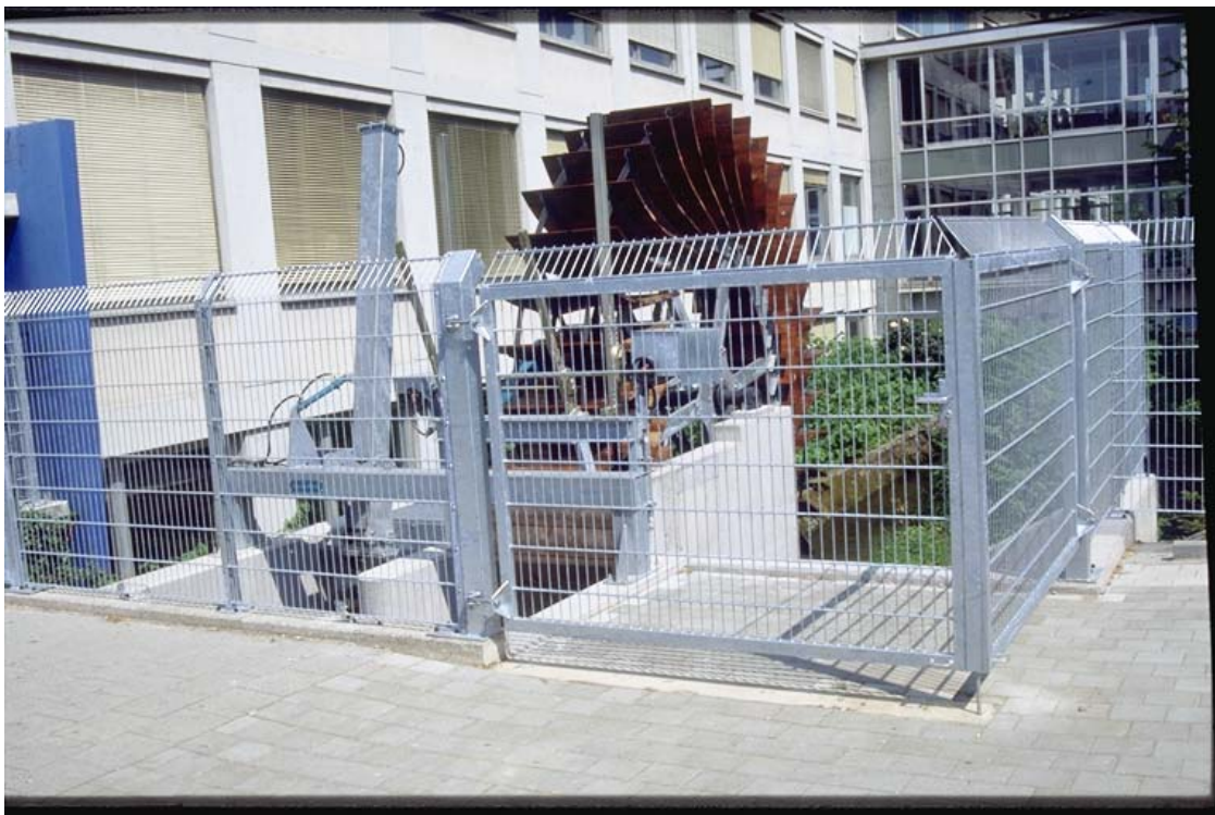
Bild 10 : Wasserrad mit Rechenreiniger und Schutzzaun
