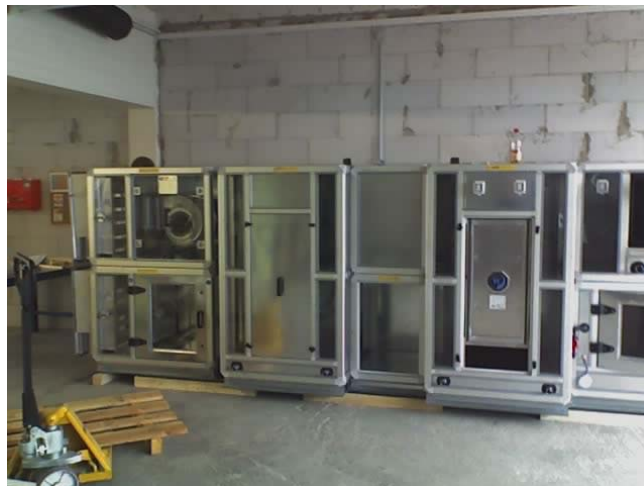
Abbildung 3.1: Demonstrationsanlage beim Testaufbau in Freiburg
