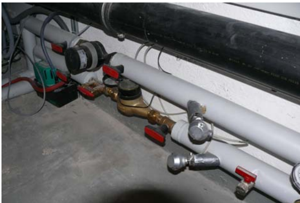
Abb. 12: Flügelradzähler und Temperaturfühler der WhisperGen-Anlage MS03_W
