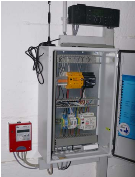
Abb. 9: Messtechnikschaltschrank mit Wärmemengen-Rechenwerk der WhisperGen-Anlage MS03_W
