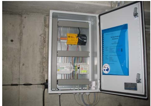
Abb. 10: Messtechnikschaltschrank mit Antenne der Lion-Anlage MS06_L
