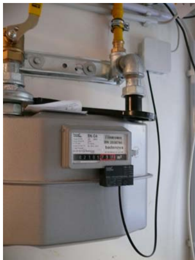
Abb. 13: Erdgaszähler mit Impulsnehmer WhisperGen-Anlage MS13_W
