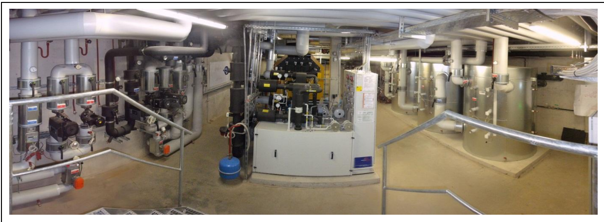
Abbildung 13: Blick in den Heizraum mit installierter Heizzentrale
