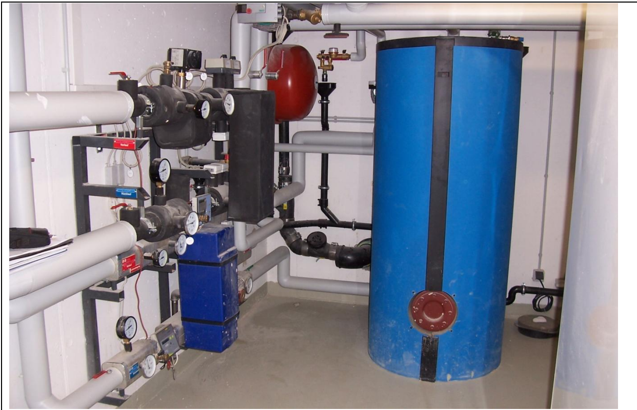
Abbildung 14: Hausstation mit Warmwasserspeicher
