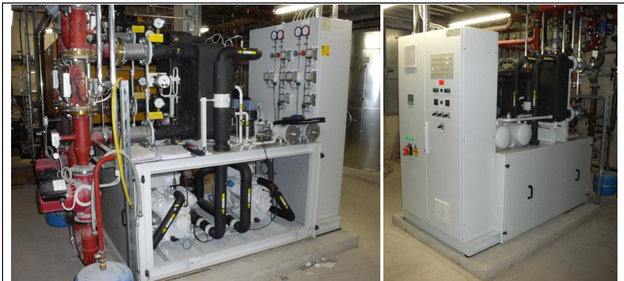
Abbildung 8. Elektrische Wärmepumpe ca. 100 kW, 4-stufig
