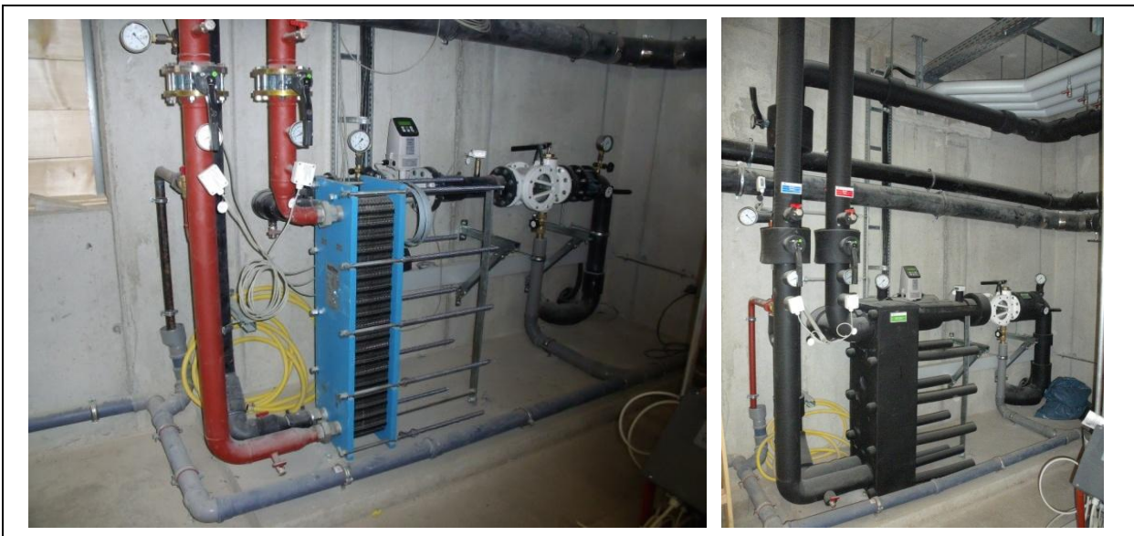
Abbildung 15: Grundwasser-Wärmetauscher in der Heizzentrale ohne bzw. mit Isolierung
