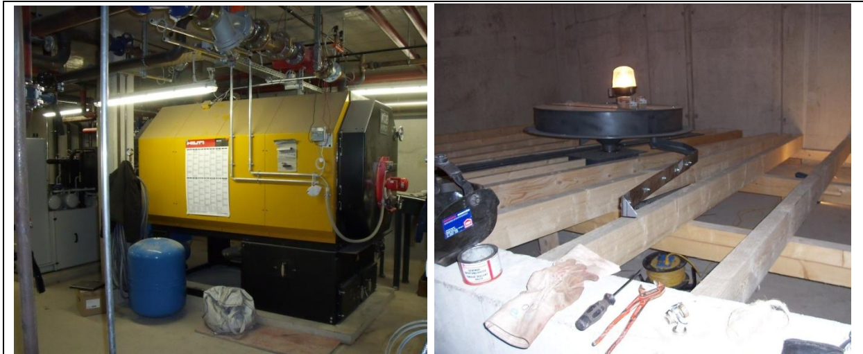
Abbildung 9. Holzpelletskessel 540 kW und Einbau Schrägboden
