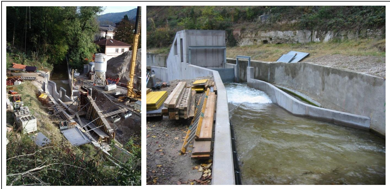
Abbildung 17: Bau der WKA mit trockengelegtem Kanal (Bachabschlag) und die fertiggestellte Bautechnik Gebäude, Streichwehr, Schütz und Leerschuss mit wieder gefülltem Kanal
