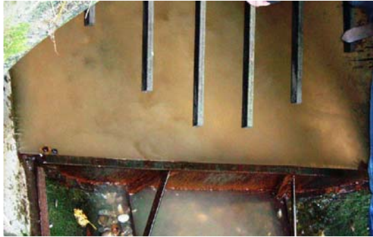
Bild 2: Metallschwelle am Auslauf zur Entnahme von Sedimenten
