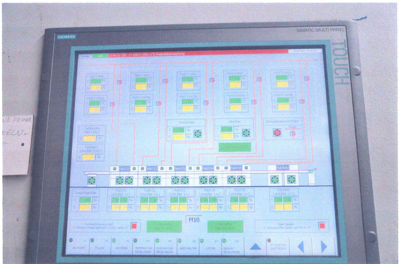
Touchscreen Steuerung Brennereinheiten
