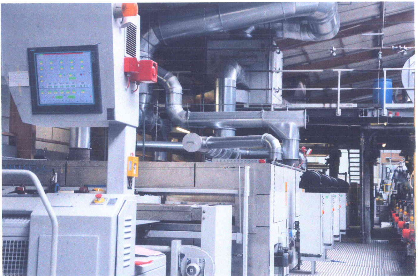
5 - Felder Spannrahmen mit Bedienbrücke
