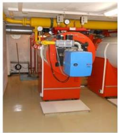
Heizkessel 285 kW th.
