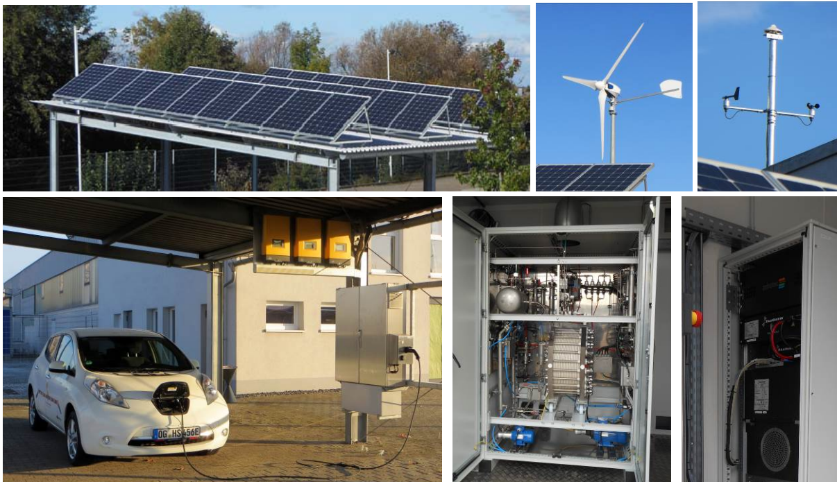
Abbildung 4: Komponenten des INES Smart Grid am Campus Nord der Hochschule Offenburg (PV-Generatoren, Klein-Windkraftanlage, Wetterstation, E-Fahrzeug Nissan Leaf mit Ladestation und Wechselrichtergruppe zur PV, Elektrolyseur, Brennstoffzelle).
