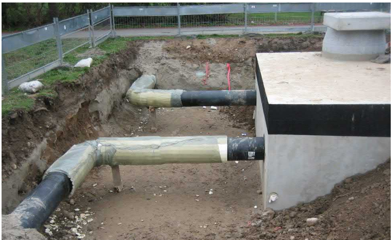
Abbildung 2: Regelstation mit Fernwärmeleitungen
