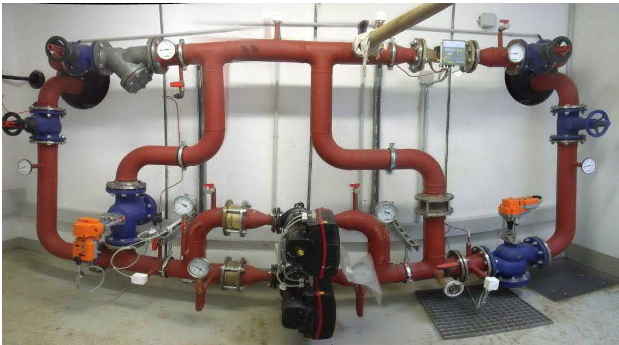
Abbildung 3: Fernwärme-Regelstation (Eintritt Fernwärme rechts)
