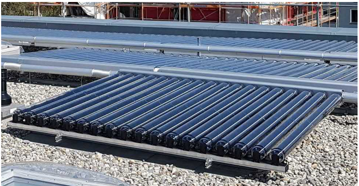
Abbildung 23: Vakuump-Röhrenkollektor-Anlage „Solaris“ (Detail): Die Röhren mit den Absorberstreifen sind um 30° in Richtung Süden (rechts) gedreht.
