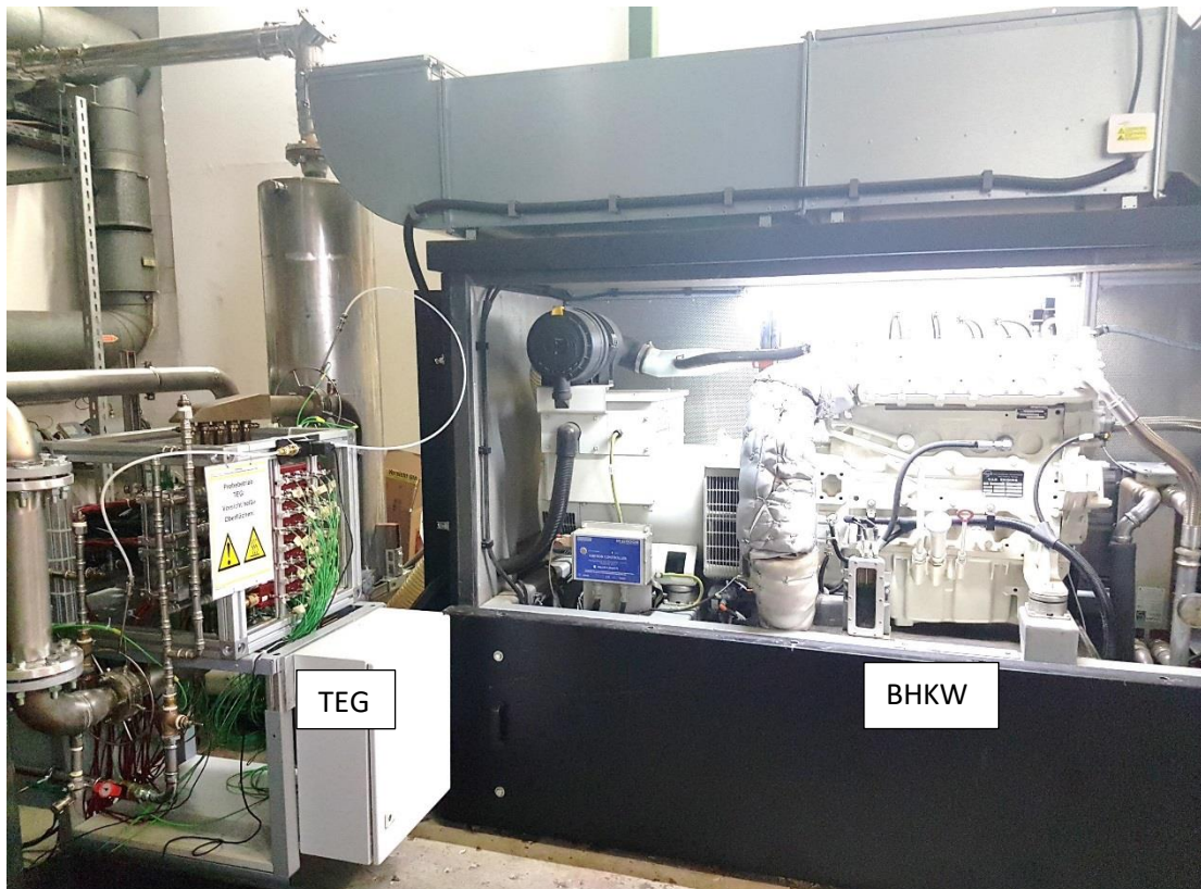
Abbildung 13: TEG nach fertiger Integration in den Abgasstrang des BHKW in Landwasser
